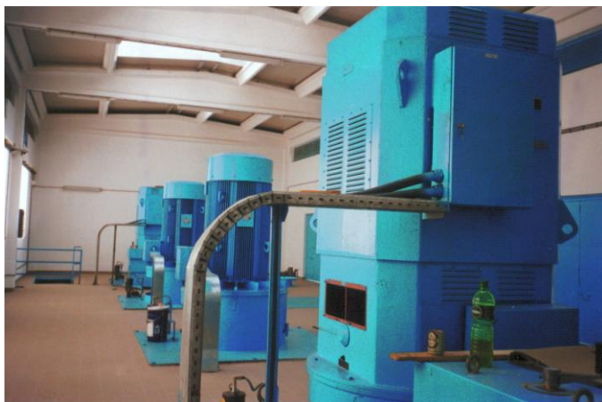
3.4: Pogonska oprema crpne stanice »Paulin dvor«, nakon obnove 2002. god.
