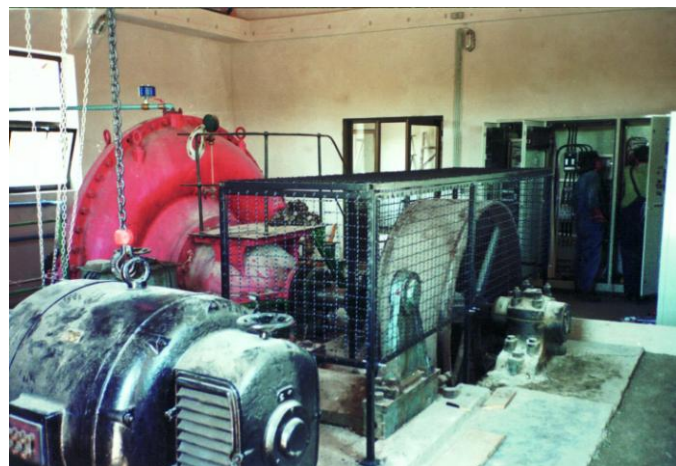
3.2: Crpni agregati i oprema crpne stanice »Podunavlje«, 2000. god.
