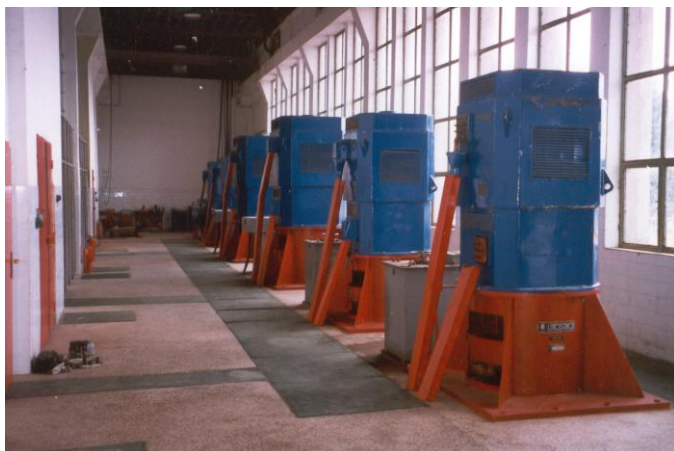
3.5: Crpna stanica »Modrić«, ušće Neretve, 1986. god, strojarnica
