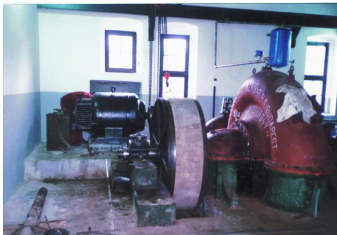
3.1: Crpni agregati i oprema crpne stanice »Zlatna greda«, 2000. god.
