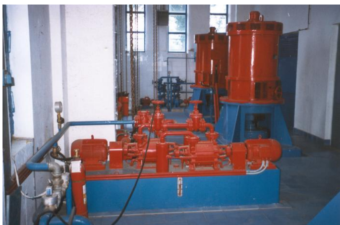
3.6: Crpna stanica »Vedrine«, Sinjsko polje 1961. Strojarnica – elektromotorni pogon i uređaji za vakumiranje
